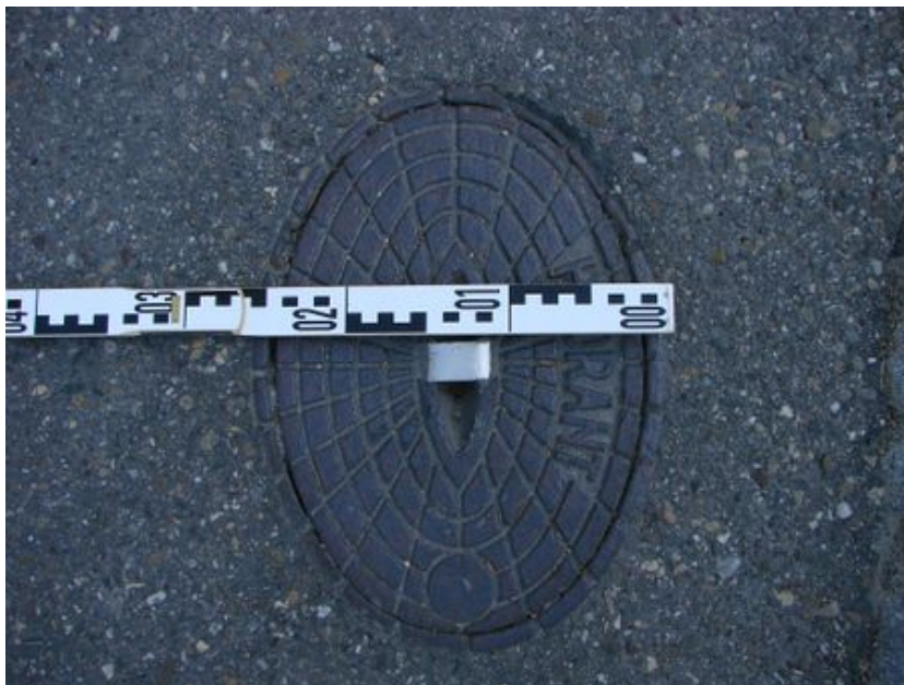
Straßenkappe eines Unterflurhydranten (Quermaß)
