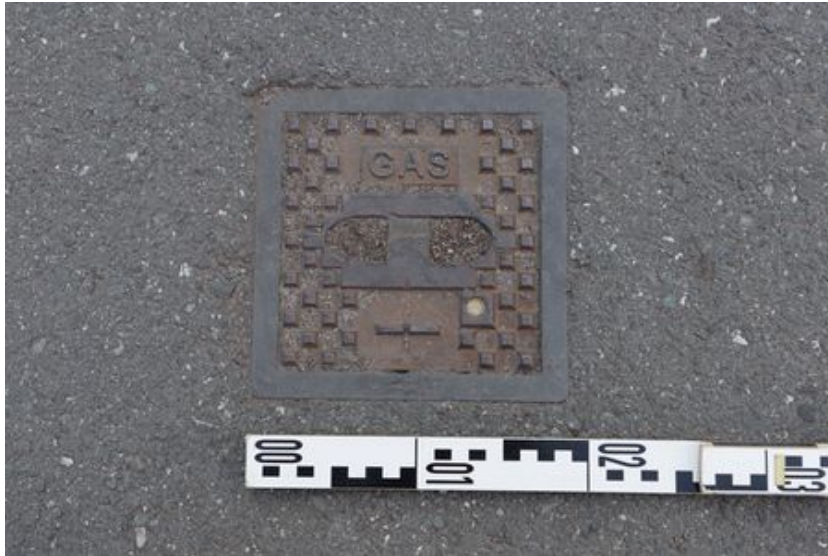
• Straßenkappe eines Absperrschiebers einer Gasleitung
